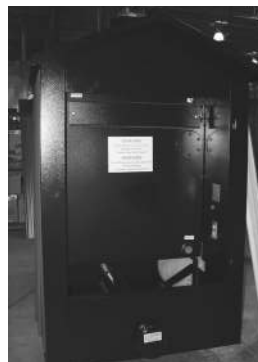
Arrière de la chaudière
